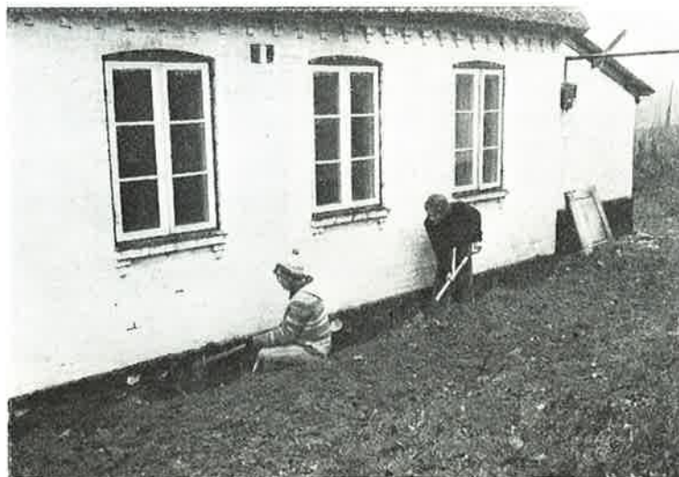
Fugten skal væk fra grunden
